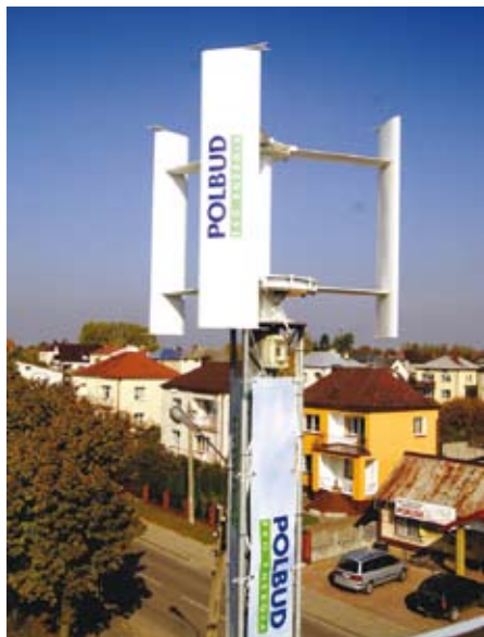
Fot. 14. Elektrownia wiatrowa o osi pionowej 10 kW; źródło: PHU Optima
