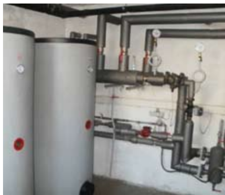
Fot. 12. Pompa ciepła w domu mieszkalnym
