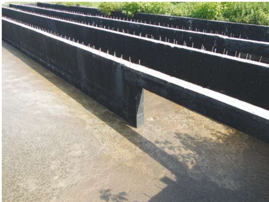
System „Slalom” w zbiornikach na gnojowicę
